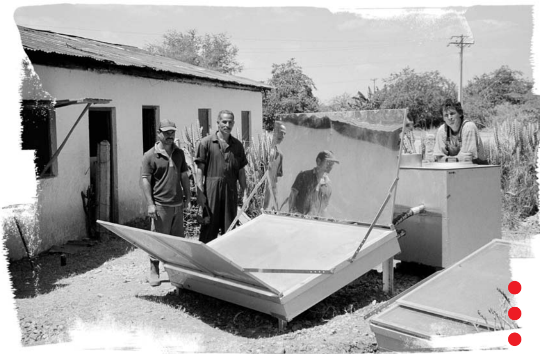
Teil der Solaranlage vor dem Küchengebäude in Santa Maria
